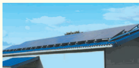
▲設置された太陽光パネル
