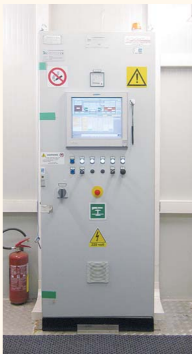
▲温度などの自動制御システム
