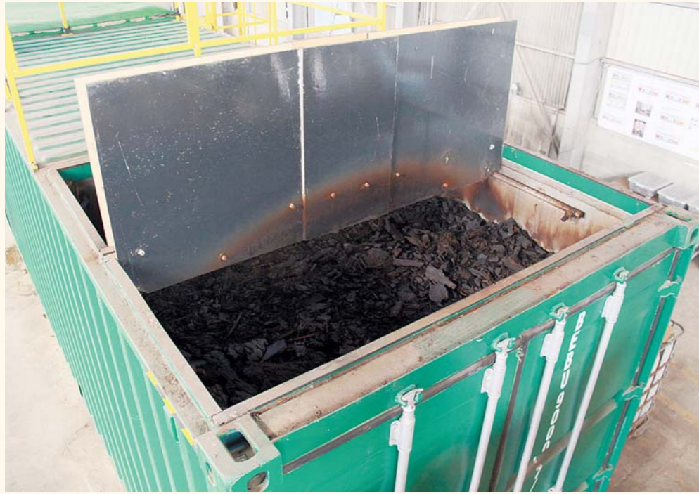
▲木質チップを使った脱臭装置 (バイオフィルター)
