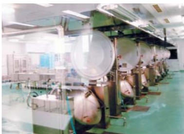
▲岩国学校給食センター 厨房：ドライ方式 調理能力：3,000食/日
