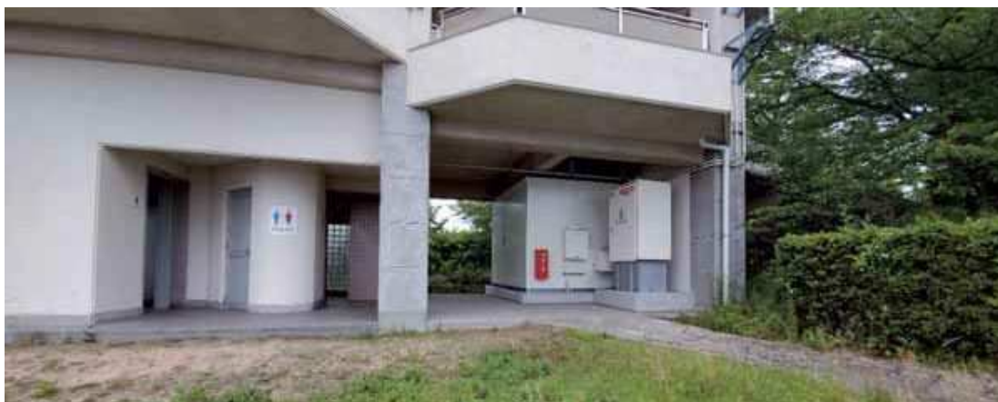
第 29 図 展望台下に設置された発電機
