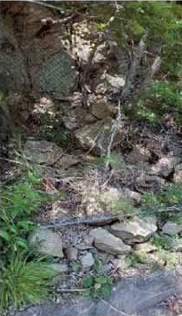
⑦落石防止ネット
