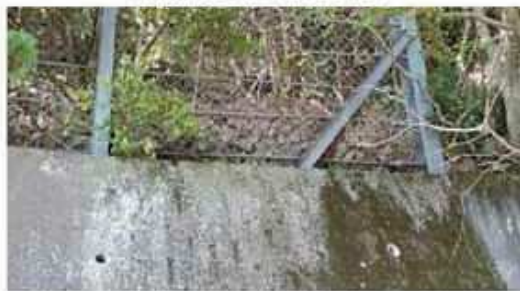
④擁壁上の落石防止ネット
