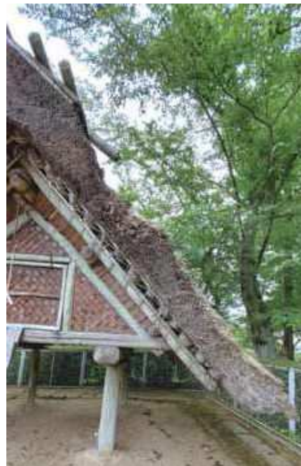
第 98 図 復元建物屋根劣化状況
