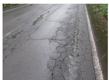
▲老朽化が進んでいる西讃広域農道
