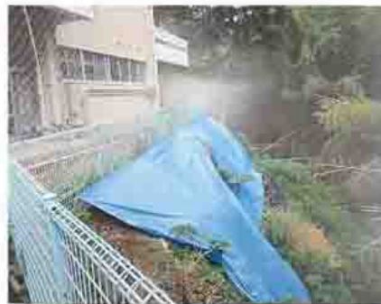
▲曾保小学校法面崩壊復旧事業
