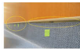
▲ 粗悪な工事をした大成建設市民病院の内装
