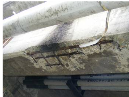
図 1.4 コンクリート橋の損傷状況
