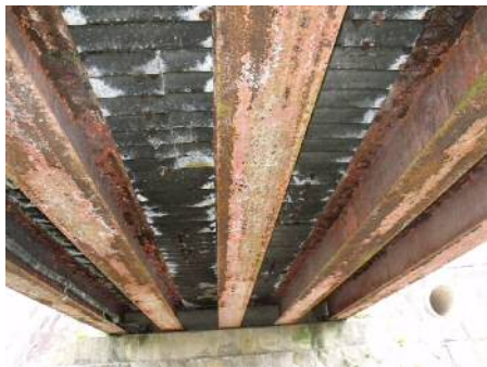
図 1.3 鋼橋の損傷状況
