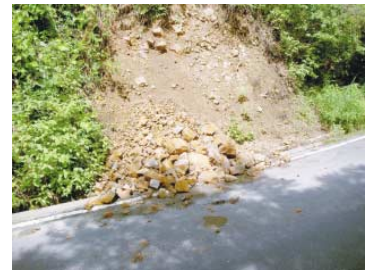
▲道に崩れ落ちた岩や土砂
