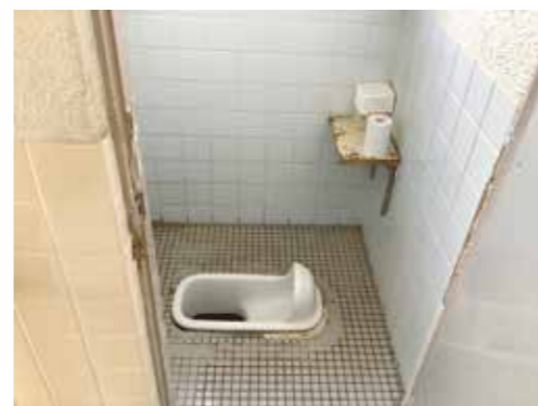
▲改修の要望が寄せられているJR高瀬駅のトイレ
